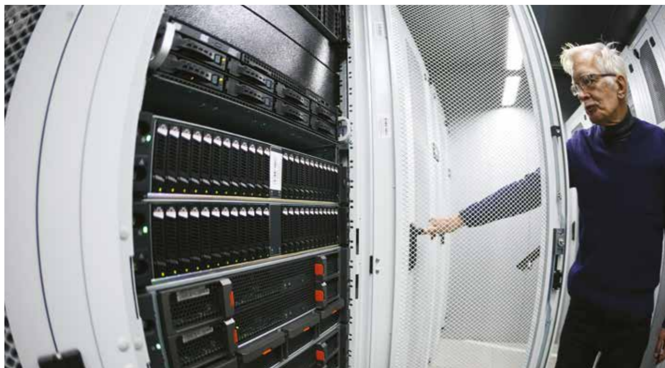
Работы по грантам РНФ: Ресурсный центр «Центр обработки данных» (машинный зал), СПбГУ
